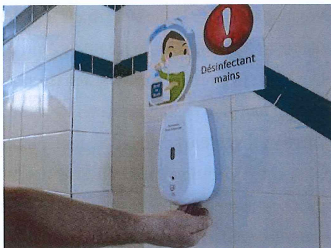
In den Toiletten hängen Desinfektionsspender an den Wänden.
